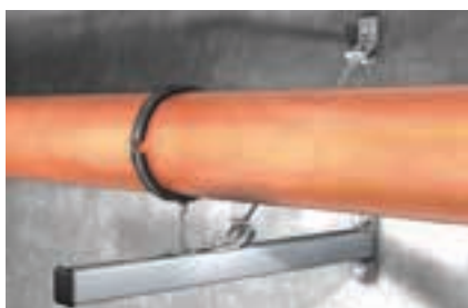
Ciężki rurociąg na wsporniku
