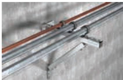
Lekkie instalacje na wsporniku
