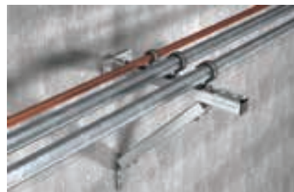
Lekkie instalacje na wsporniku
