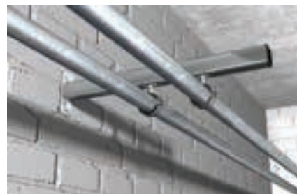
Rurociągi mocowane na wspornikach
