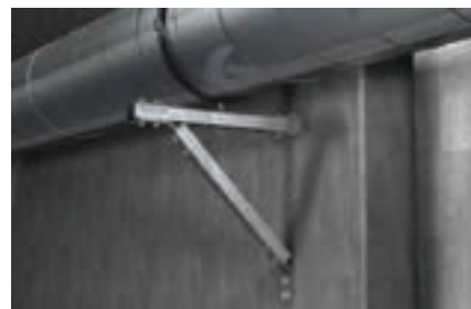
Rurociąg wentylacyjny na wsporniku
