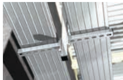
Trasy kablowe na wspornikach
