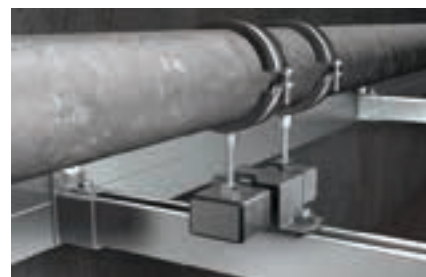
Wydłużenie rury zamocowanej na elemencie przesuwным
