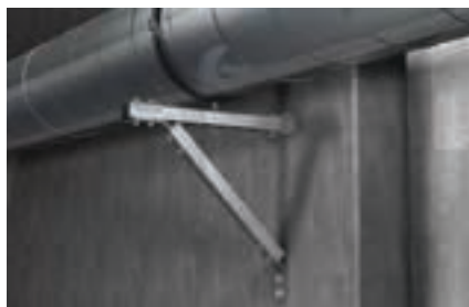
Rura spiro na wsporniku
