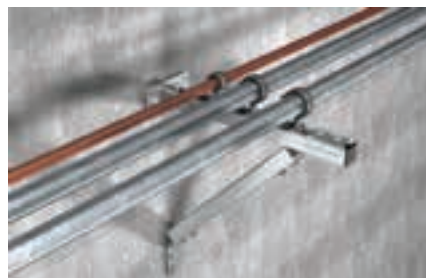
Lekka instalacja rurociągowa na wsporniku
