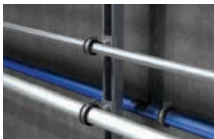
Równoległe rurociągi zamontowane na szynie
