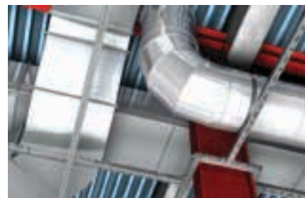
Konstrukcja wsporcza dla kanałów wentylacyjnych
