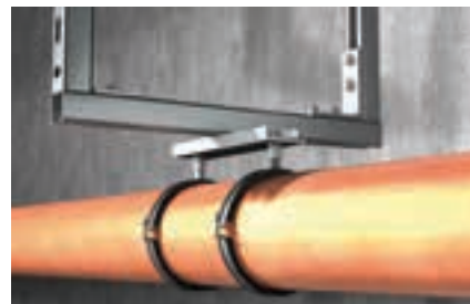
Wydłużenie rurociągów podwieszonych na mocowaniu ślizgowym
