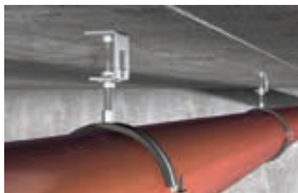
Podwieszona instalacja rurociągu z możliwością regulacji
