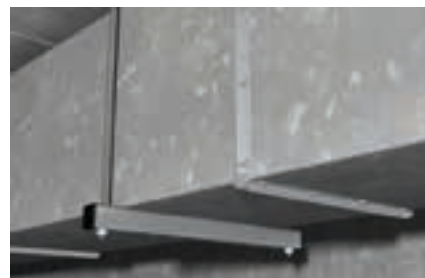
Podwieszony kanał wentylacyjny
