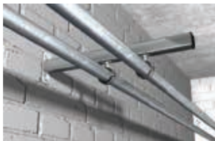
Rurociągi na wsporniku
