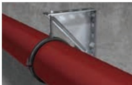
Ciężka rura podwieszona na wsporniku kątowym
