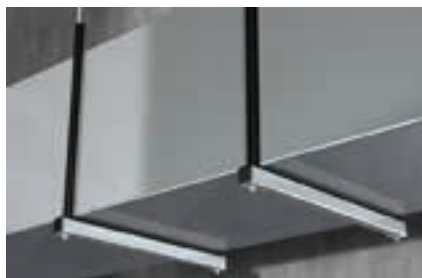
Kanał wentylacyjny podwieszony na szynach z izolacją
