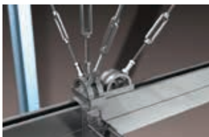
Stężenia rusztu instalacyjnego
