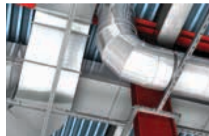
Konstrukcja wsporcza dla kanałów wentylacyjnych
