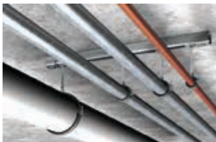
Lekkie rurociągi podwieszane
