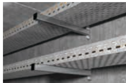
Wsporniki pod trasy kablowe
