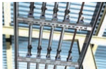
Element przesuwny na ruszcie medialnym
