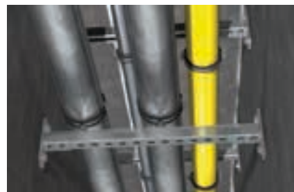
Instalacje rurociągowie w przejściu ewakuacyjnym
