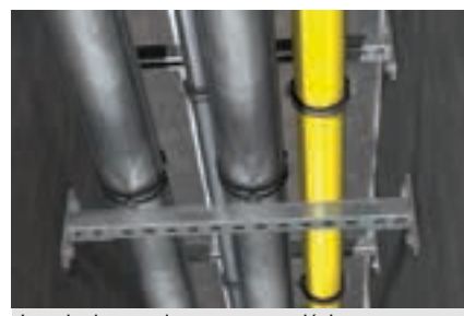
Instalacje rurociągowie w przejściu ewakuacyjnym
